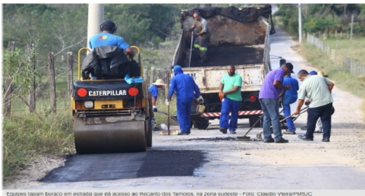
Equipes tapam buraco em estrada que dá acesso ao Recanto dos Tambores, na zona sudeste - Foto: Claudio Vieira/PMSJC
