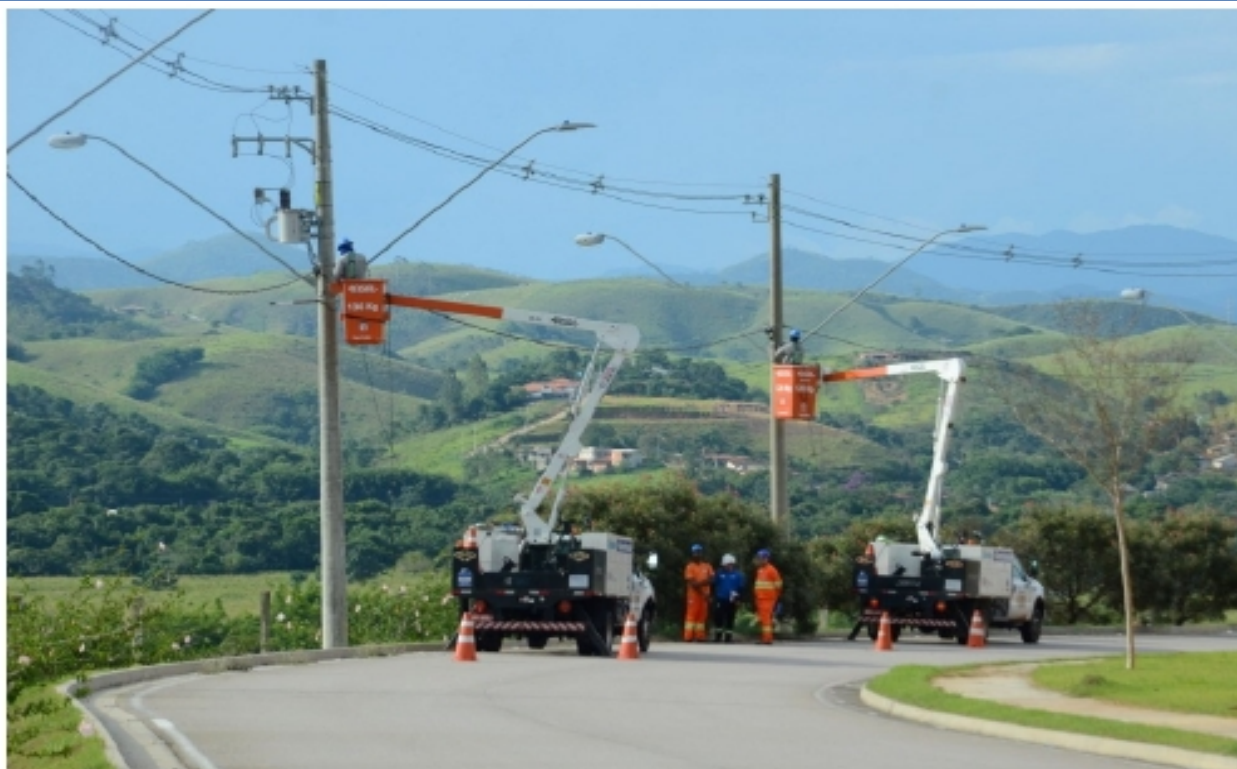
Ruas externas do bairro Urbanova recebem iluminação de LED. (16/3)
